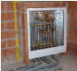
installation encaissée dans le mur
